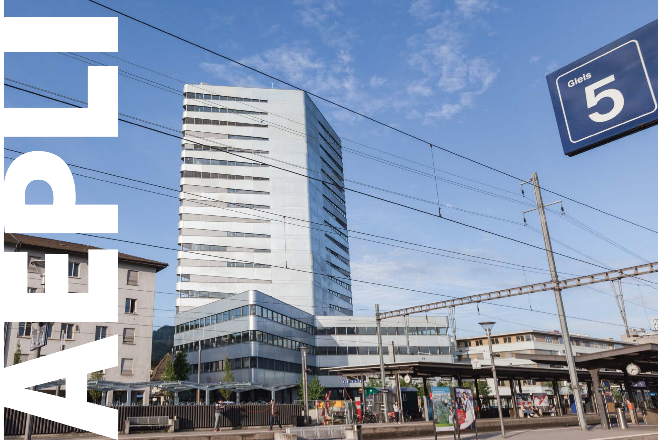
Von null auf 66 m in nur sechs Monaten – die 22-geschossige Fassade aus 160 Tonnen Stahlblech verlangte von den Projektbeteiligten bei jedem Arbeitsschritt Topqualität und Erfindungsreichtum.
